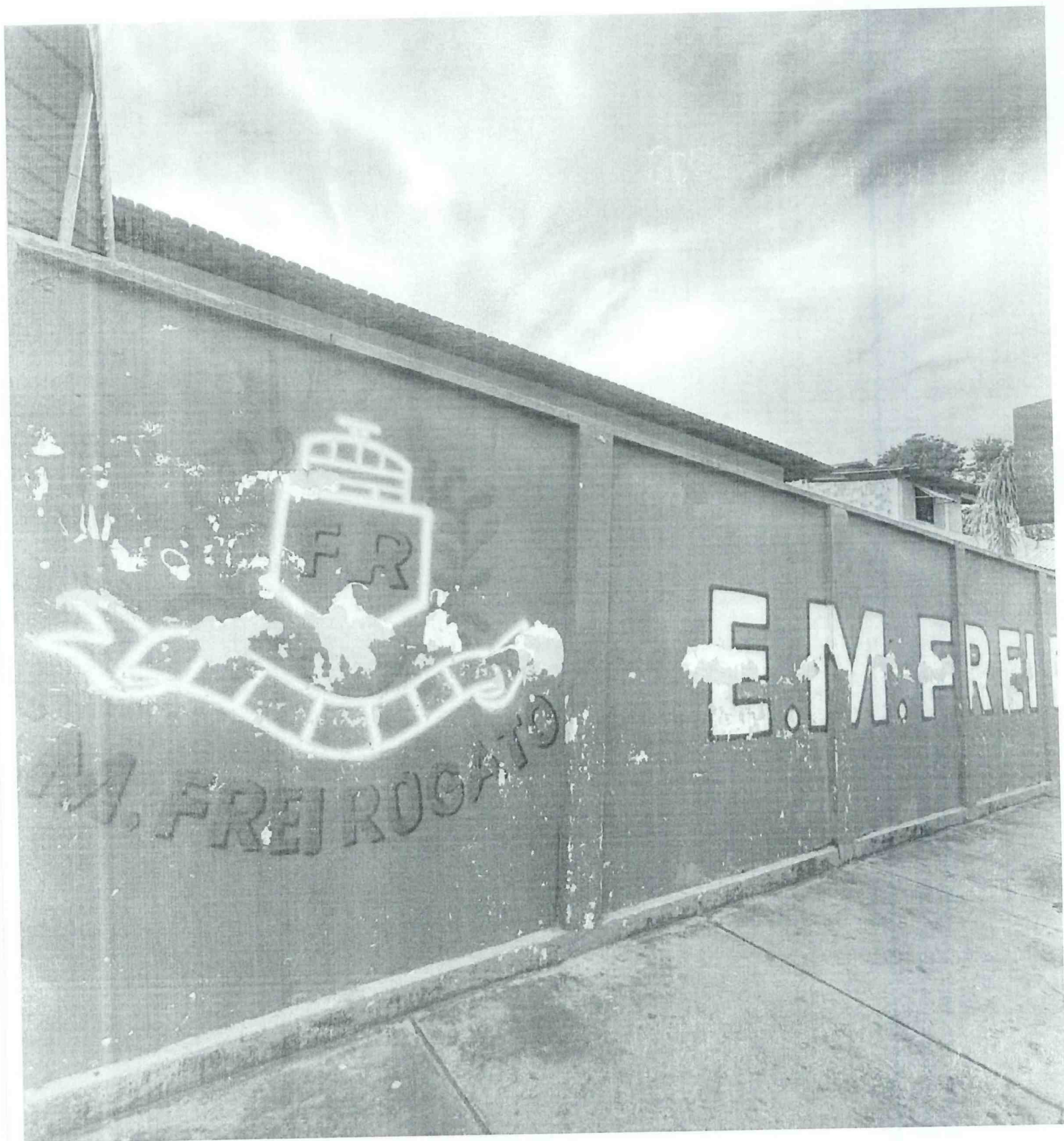
Muro em má condição, descascando.
